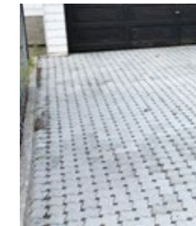
Permeable flater er vanngjennomtrengelige flater som grus, permeabel (med hull) belegningsstein etc.
